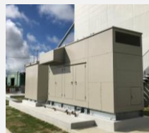
非常用 自家発電装置
